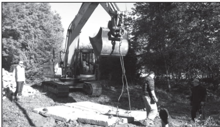
Na dalszą budowę i modernizację kanalizacji sanitarnej wydatkowano 530.739,11 zł. Na zdj. remont sieci na ul. Zachodniej we Włoszakowicach
